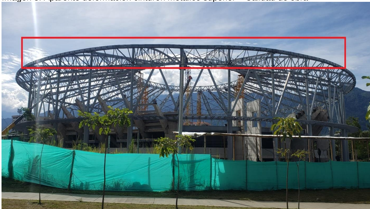
Imagen 8. Aparente deformación cinturón metálico superior – Calidad de obra
